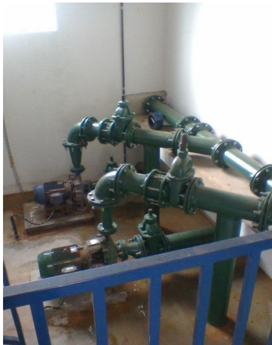
Figura 10 – Estação Elevatória de Água Tratada
