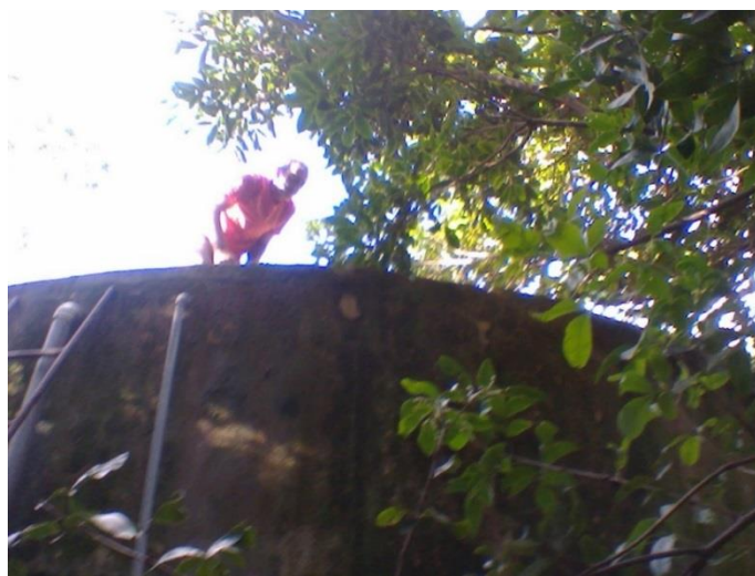
Figura 15 – Reservatório Localidade de São José da Chácara
