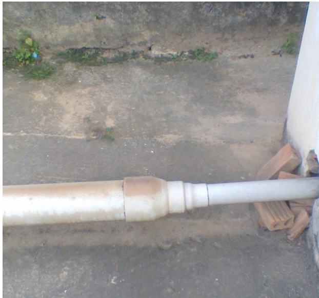
Figura 30: Saída do esgoto da E.E.E do Bairro Poção para a rede mestra
