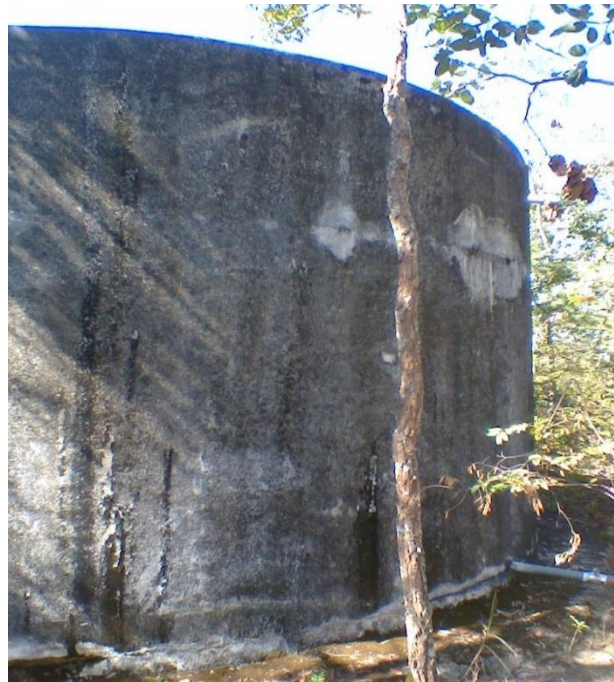
Figura 13 – Reservatório Localidade de Boa Vista
