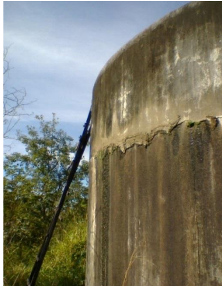
Figura 24 – Reservatório 1 Localidade de Catita de Baixo
