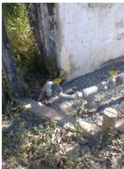
Figura 21 – Poço 1 Localidade de Catita de Baixo
