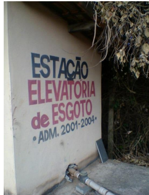
Figura 28: Estação Elevatória de Esgoto (E.E.E) do Bairro Estiva
