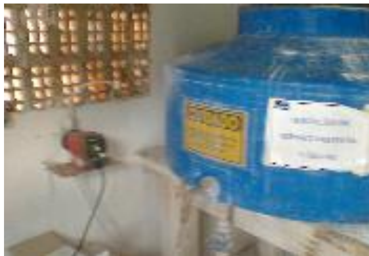
Figura 4 – Dosadores de Cloro e Flúor
