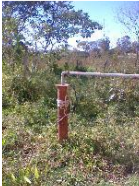
Figura 22 – Poço 2 Localidade de Catita de Baixo
