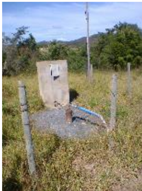
Figura 23 – Poço 3 Localidade de Catita de Baixo
