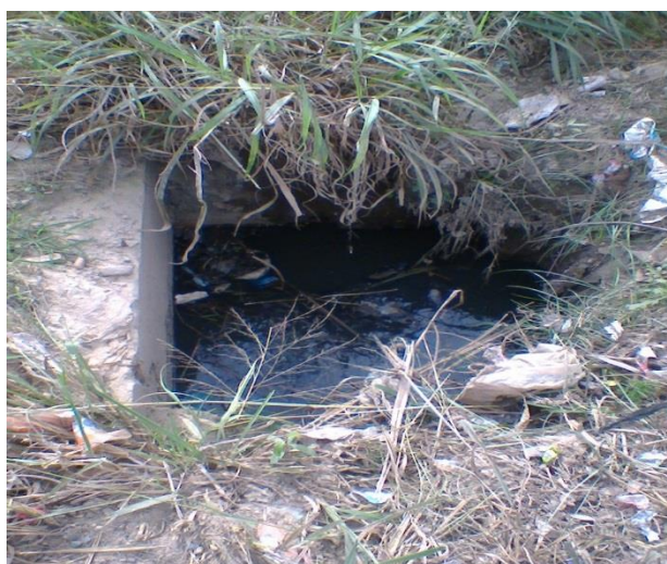
Figura 57: Lançamento clandestino de esgoto em elemento de drenagem no bairro Cidade Nova
