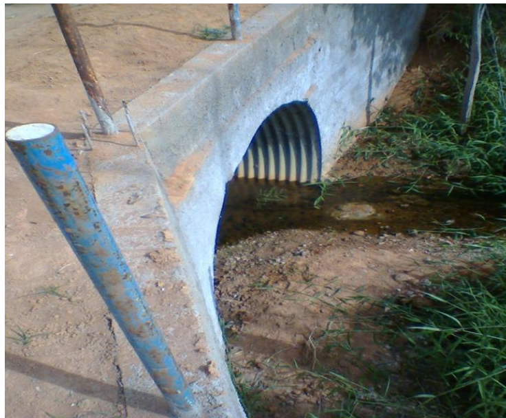
Figura 52 – Tubo Armco - Bairro Jardim Canela: Córrego Maravilhas
