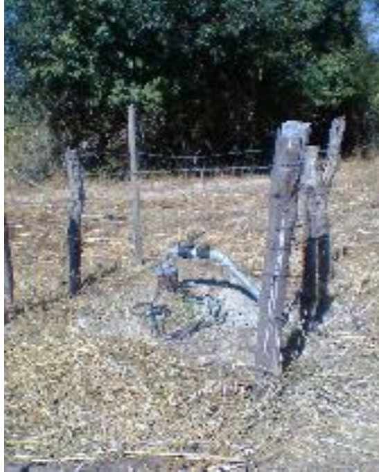
Figura 12 – Poço de captação localidade de Boa Vista
