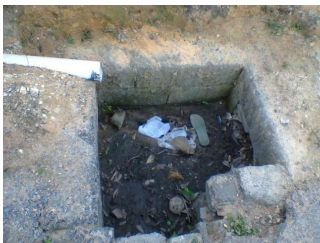
Figura 58: Lançamento clandestino de esgoto em elemento de drenagem - parte baixa do Bairro das Casas Populares (bairro das Casinha)
