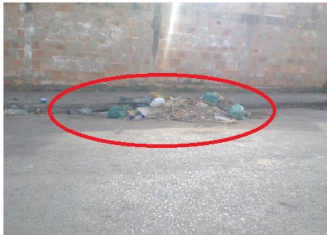
Figura 55: Resíduos acumulados nas sarjetas, podendo dificultar o escoamento da água
