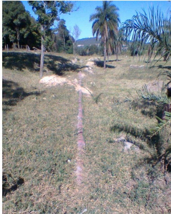
Figura 32: Chegada do esgoto a ETE Maravilhas, manilha de cerâmica 200mm
