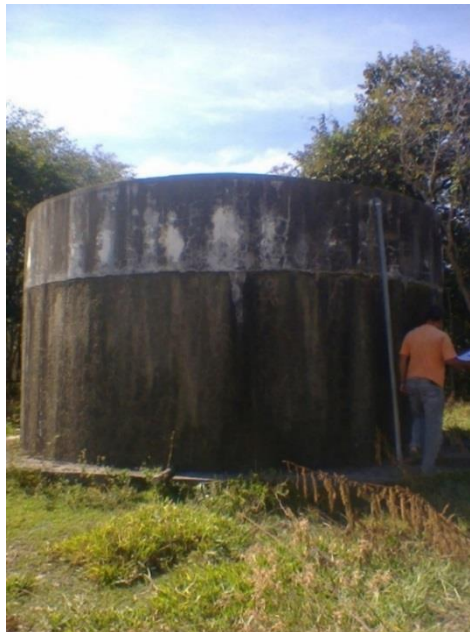
Figura 25 – Reservatório 2 Localidade de Catita de Baixo
