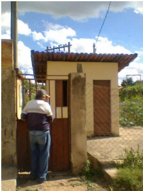
Figura 27: Estação Elevatória de Esgoto (E.E.E) do Bairro Poção
