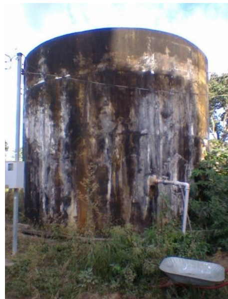
Figura 17 – Reservatório 1 Localidade de Catita de Cima
