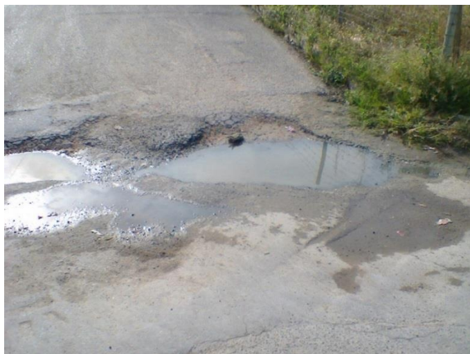
Figura 62: Pavimentação deteriorada por falta de drenagem parte central Fonte: Projeta Engenharia (2015)
