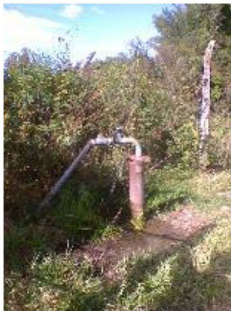
Figura 19 – Poço Localidade de Catita do Meio
