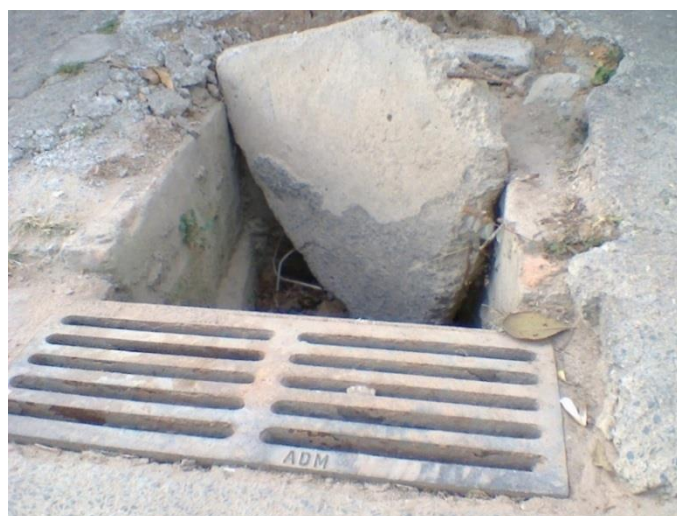
Figura 56: Estrutura de sistema de drenagem danificado, bairro da Serra
