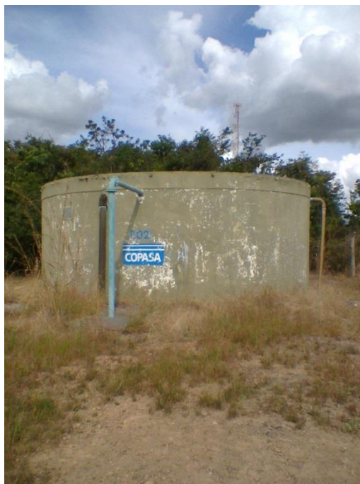
Figura 11 – Reservatório de água tratada da COPASA (R2)
